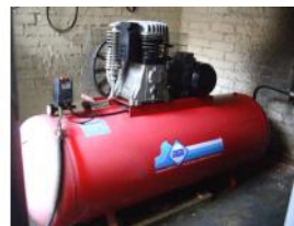
Referencia: ATG-029 COMPRESOR Año: 2004 Marca: AC DGM
