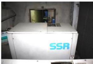
Referencia: EST-043 COMPRESOR Año: . Marca: INGERSOLLRAND
