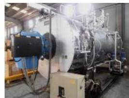
Referencia: TIG-001 CALDERA DE VAPOR PIROTUBULAR H... Año: 2001 Marca: STEAMBLOC
