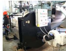
Referencia: TPS-022 CALDERA DE VAPOR Año: 2001 Marca: VYC INDUSTRIAL
