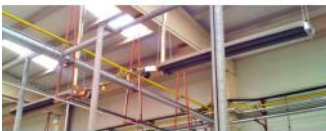
Referencia: MOL-068 CALEFACCION A GAS POR TUBO RADIANTE Año: . Marca: .
