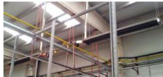
Referencia: MOL-069 CALEFACCION A GAS POR TUBO RADIANTE Año: . Marca: .
