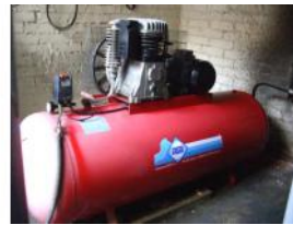
Referencia: ATG-029 COMPRESOR Año: 2004 Marca: AC DGM
