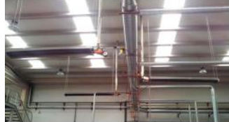
Referencia: MOL-071 CALEFACCION A GAS POR TUBO RADIANTE Año: . Marca: .
