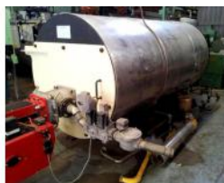
Referencia: M-1477 CALDERA DE VAPOR Año: 2001 Marca: SOGECAL
