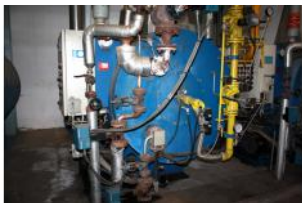
Referencia: LUI-051 CALDERA DE VAPOR Año: 1998 Marca: BABCOCK WANSON
