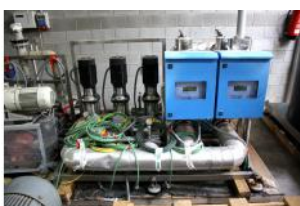
Referencia: BPS-025 GRUPO DE 3 BOMBAS CON 2 GRUPOS... Año: CRN 10-05 A-FGS-G-E-HQQE Marca: GRUNDFOS
