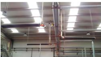
Referencia: MOL-072 CALEFACCION A GAS POR TUBO RADIANTE Año: . Marca: .
