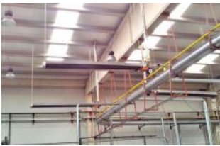
Referencia: MOL-066 CALEFACCION A GAS POR TUBO RADIANTE Año: . Marca: .
