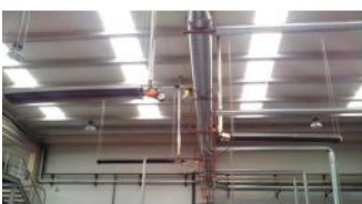
Referencia: MOL-072 CALEFACCION A GAS POR TUBO RADIANTE Año: . Marca: .
