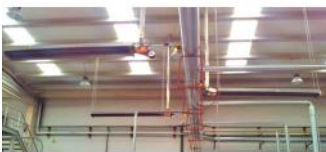
Referencia: MOL-070 CALEFACCION A GAS POR TUBO RADIANTE Año: . Marca: .
