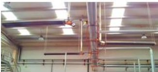
Referencia: MOL-070 CALEFACCION A GAS POR TUBO RADIANTE Año: . Marca: .
