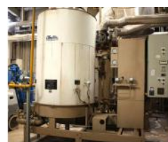
Referencia: TIP-119 CALDERA DE VAPOR Año: 1994 Marca: CLAYTON
