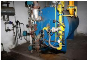
Referencia: LUI-049 CALDERA DE VAPOR Año: 2000 Marca: BABCOCK WANSON
