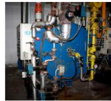
Referencia: LUI-050 CALDERA DE VAPOR Año: 1998 Marca: BABCOCK WANSON
