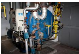
Referencia: LUI-052 CALDERA DE VAPOR Año: 1998 Marca: BABCOCK WANSON
