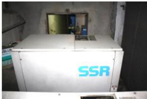
Referencia: EST-043 COMPRESOR Año: . Marca: INGERSOLLRAND
