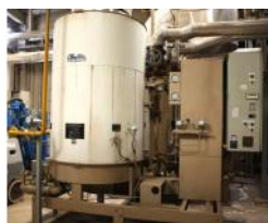
Referencia: TIP-119 CALDERA DE VAPOR Año: 1994 Marca: CLAYTON
