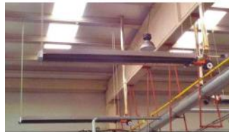
Referencia: MOL-067 CALEFACCION A GAS POR TUBO RADIANTE Año: . Marca: .
