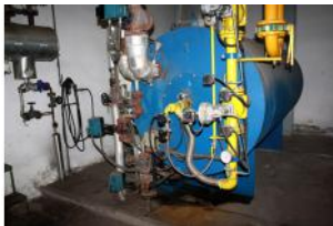
Referencia: LUI-049 CALDERA DE VAPOR Año: 2000 Marca: BABCOCK WANSON
